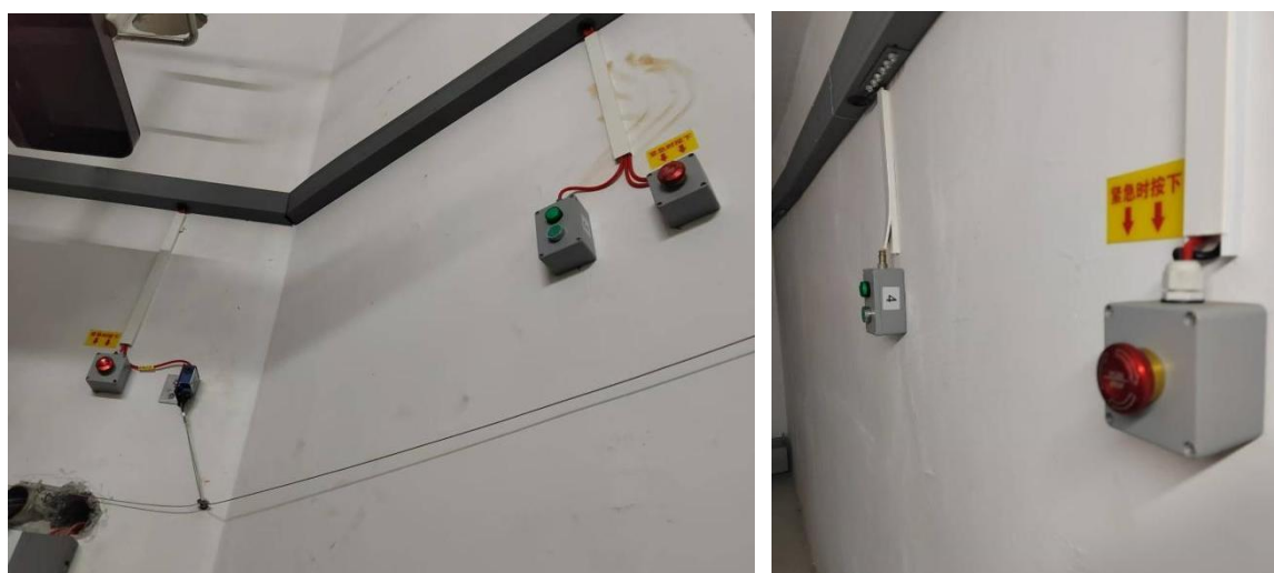
急停按钮、巡视撤离、拉线开关
